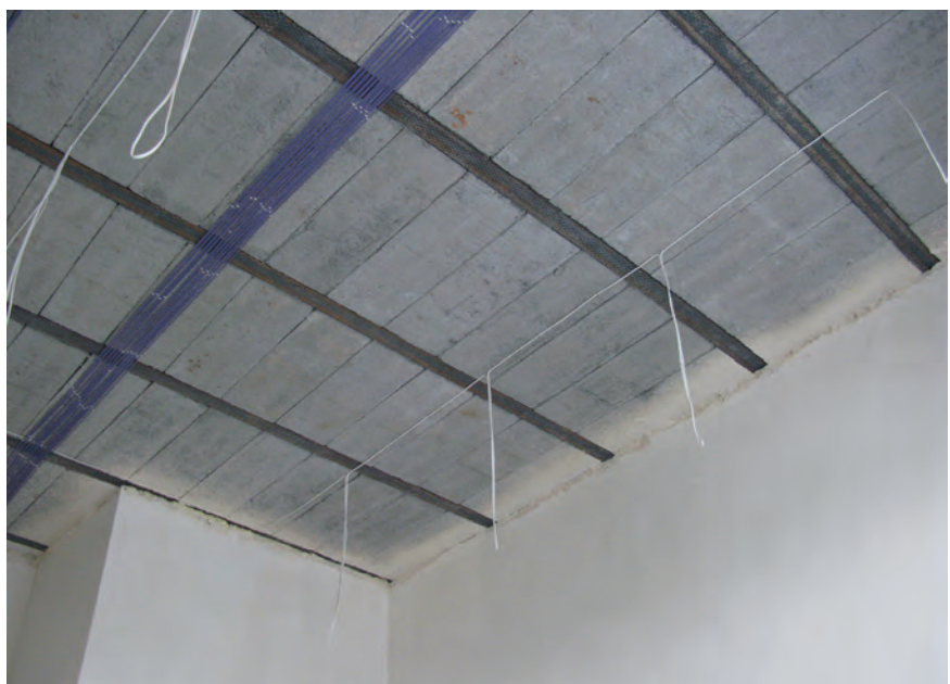
WPS-tak sett nedenfra.
