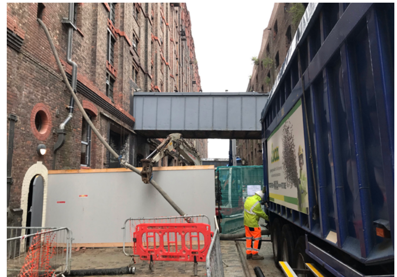
Brukte et rørsystem på 50 meter over en 10 meter vegghindring.
